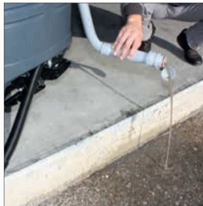
1. Entleeren des Frisch- und Abwassertanks.
