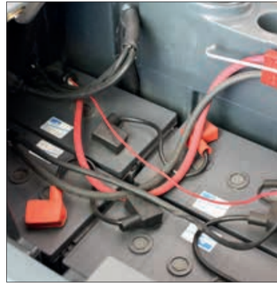
2. Batteriekontrolle – Füllstand der Säure überprüfen (bei Naßbatterien).
